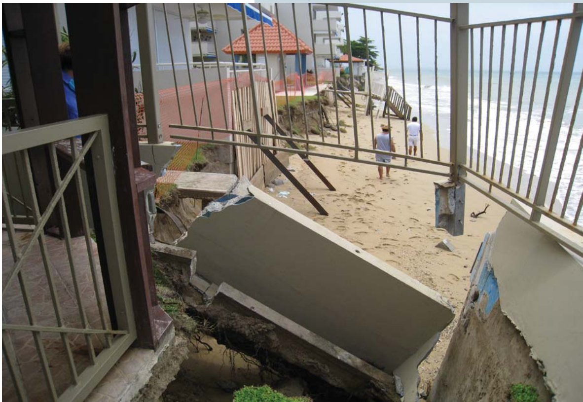
Edificios de Apartamentos afectados por marejadas en 2008 (Rincón, Puerto Rico)
